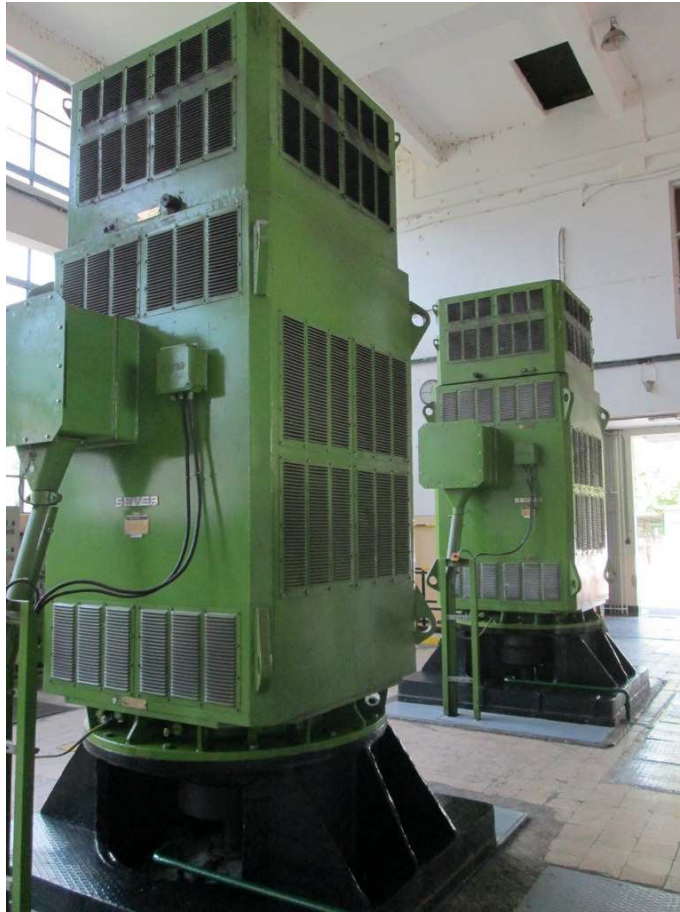
4db 1,4MW-os kaszkád hajtás 4db motorhoz ISD Power Dunaújváros
