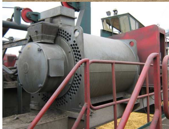
80db 630kW-os szállítószalag lágyindító hajtás Mátrai Erőmű Zrt. Visontai és Bükkábrányi bánya
